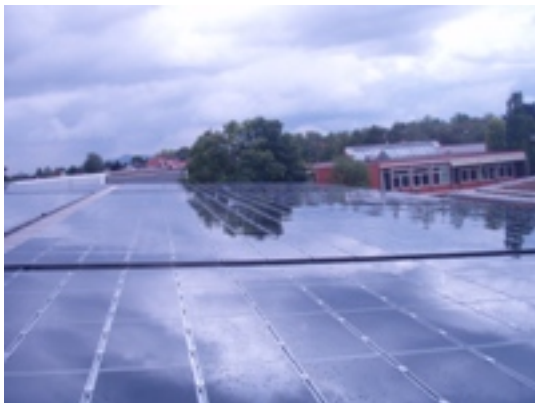
Dünnschichtanlage Karolinger Sporthalle in Waiblingen
