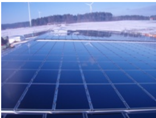
Dünnschichtanlage in Renquishausen
