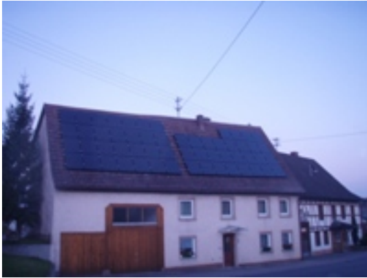
Dünnschichtanlage in Bingen
