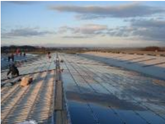
Dünnschichtanlage in Herbertingen
